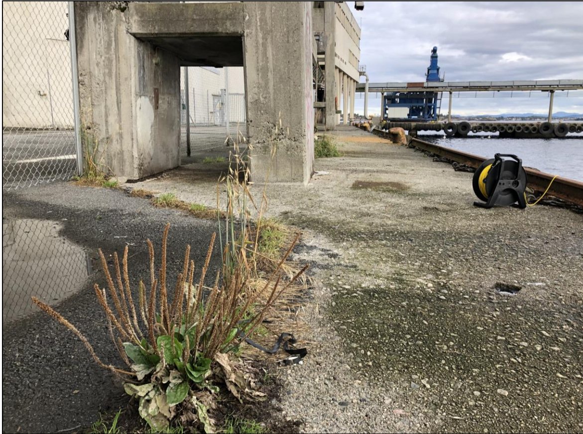
Figur 5. I sprekker mellom bygninger og asfalt og på organisk løsmateriale som har samlet seg i hjørner og langs vegger er det stedvis litt vegetasjon selv der miljøet er dominert av harde uorganiske flater. Foto: Bjarne Homnes Oddane.
